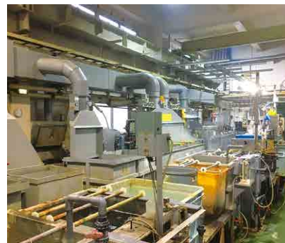
今回導入しためっき装置と冷却ポンプ
