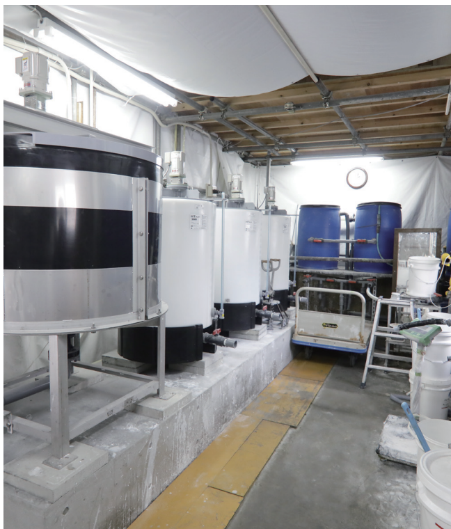
▲補助事業で購入したタンク類。新製品のECO5000の量産体制を構築
