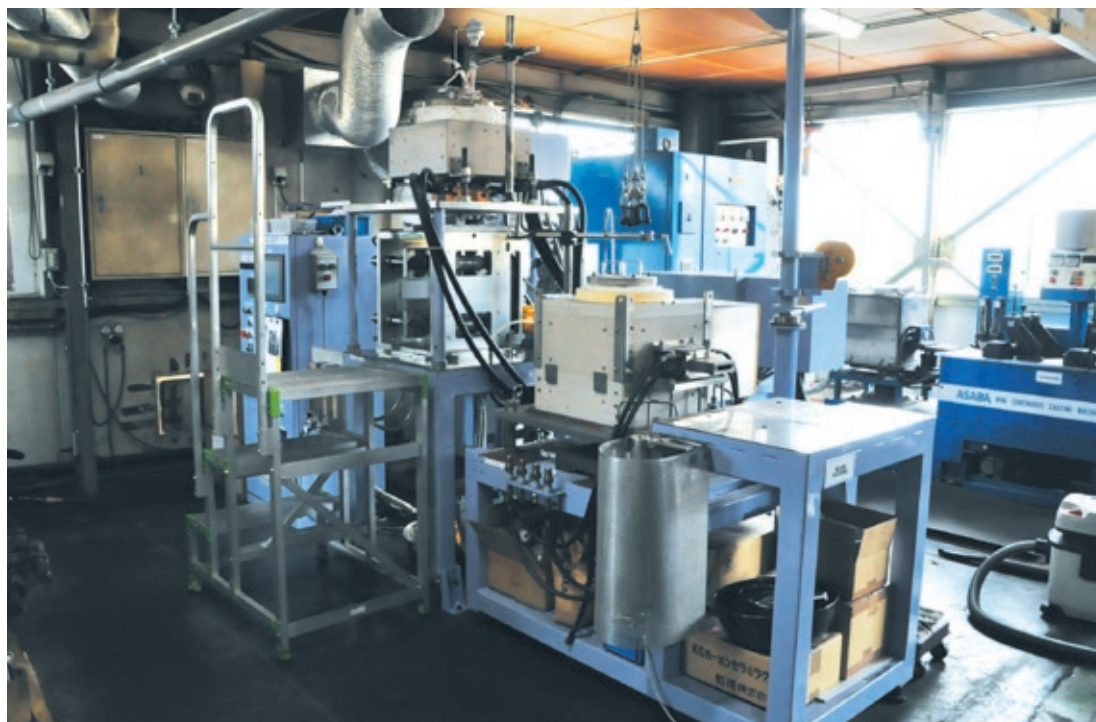
導入された連続鑄造装置
