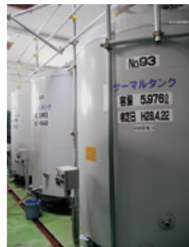
冷温管理を行うサーマルタンク
