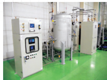
水素ガス・窒素ガス混合装置
