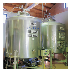
導入した特殊ネオサーマルタンク
