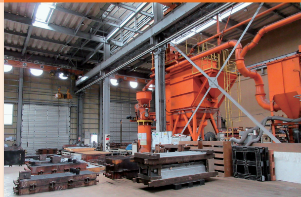
2012年に建設した新工場の内部
