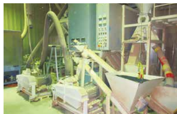
補助事業で導入した製造ライン
