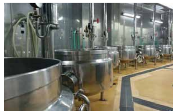
補助事業で導入した蒸気釜
