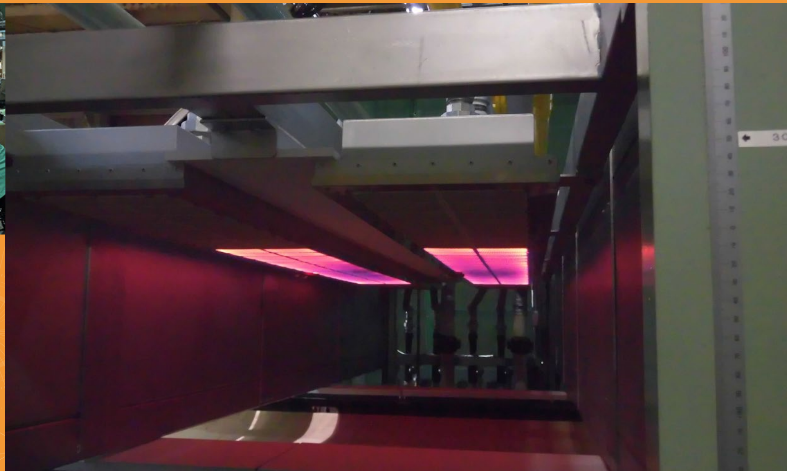
■ 生産性向上、省エネルギー化を実現したガス赤外線予備乾燥炉
