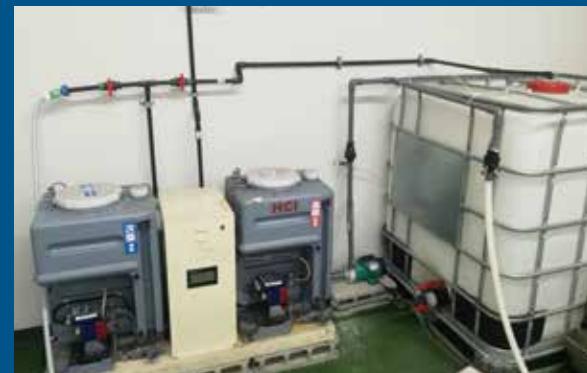
【高濃度次亜塩素酸水生成設備】
