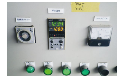
温度監視システム
