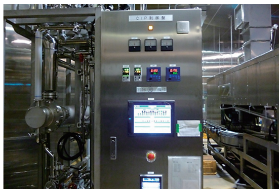
導入設備：自動洗浄システム
