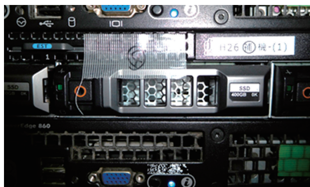
導入設備：高性能サーバ、他に分散処理用に3台導入
