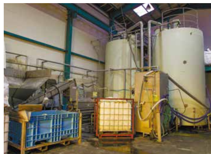
飼料製造設備
