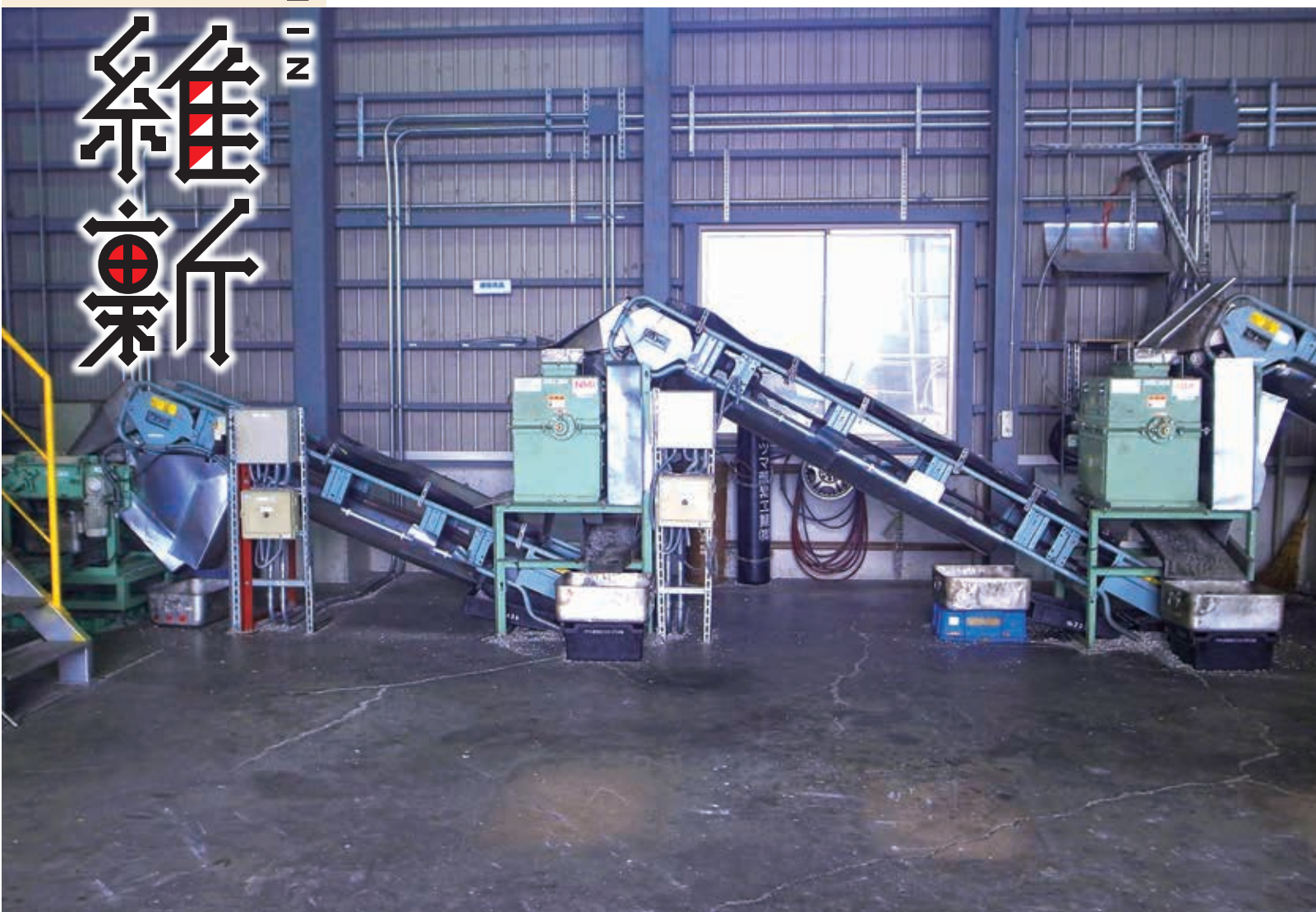
金属選別システム設備
