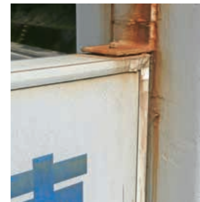
錆による腐食した看板
