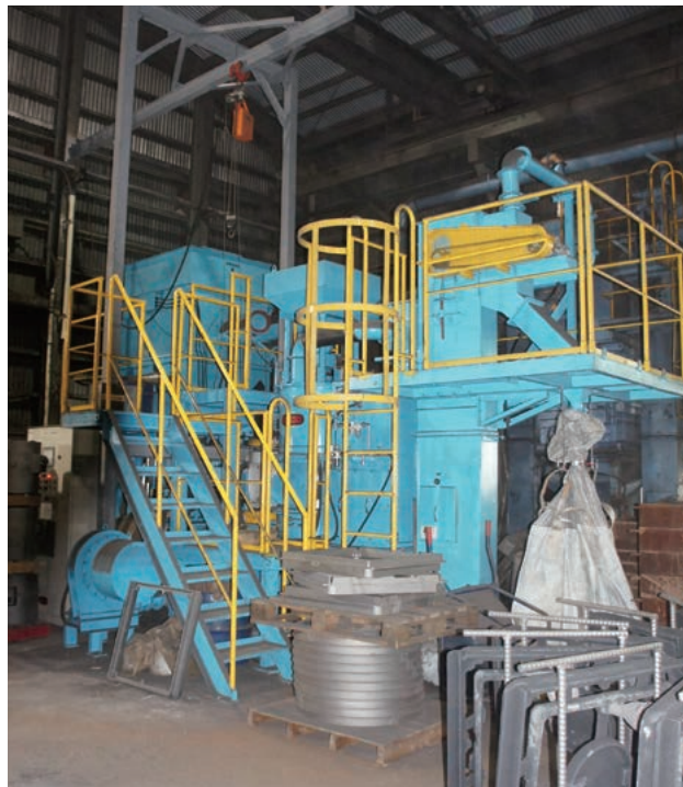
集じん機、粉碎機、再生機が並ぶ「生型廃棄砂再生設備」
