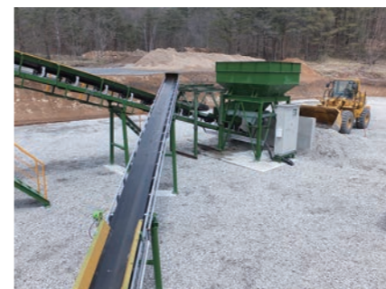
アスファルト破砕プラントの例
