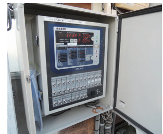
温室内に設置された遮光スクリーン装置の制御盤
