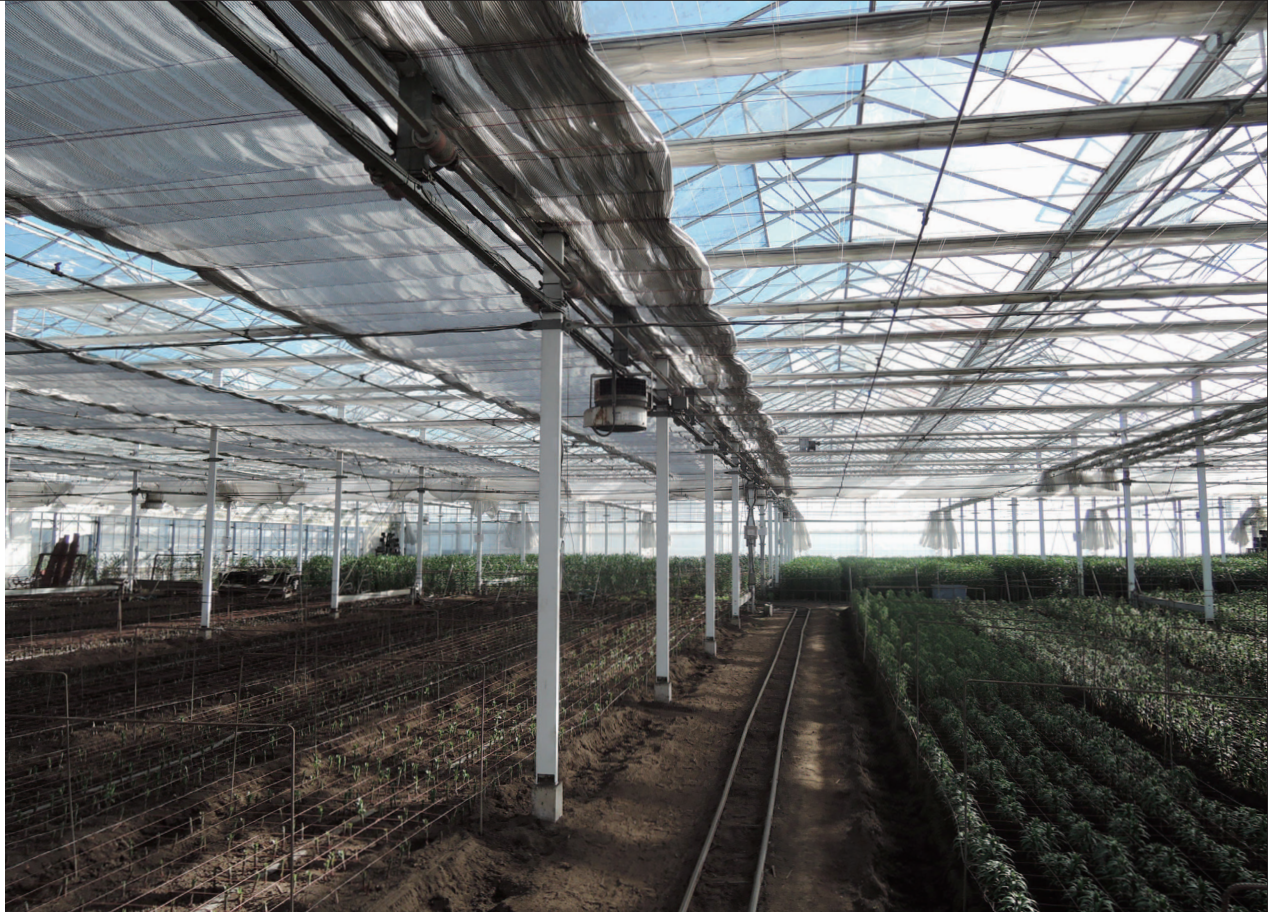
光環境改善のための遮光スクリーン装置
