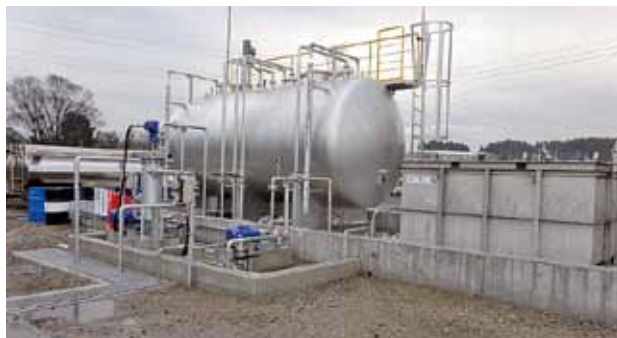
中和施設・ブレンド装置
