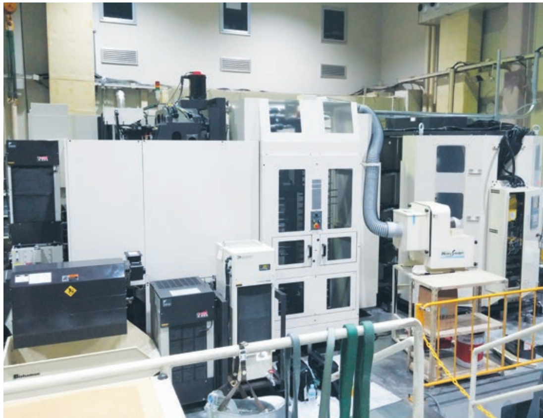
導入した多面パレットストッカー(右奥)を取り付けた5軸加工機(左奥)
