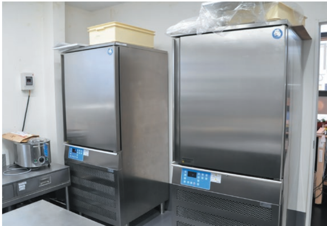
導入された最新の急速冷凍機
