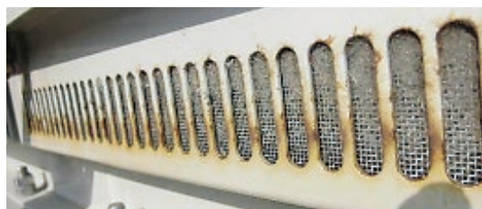
事業前の発錆状況
