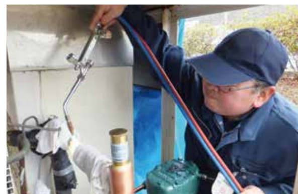
フロン排出抑制法に遵守したメンテナンスサービスを確立
