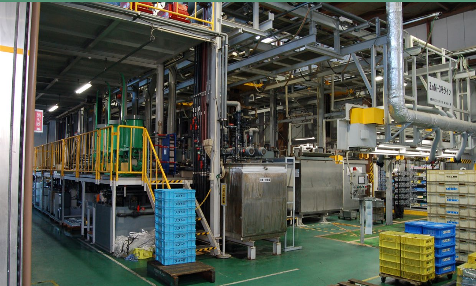
■ 開発した隔膜電極方式のメッキライン
