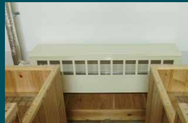
【室内を加温するコンベクター】
