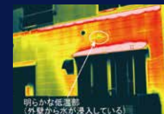
【赤外線サーモグラフィ画像】
