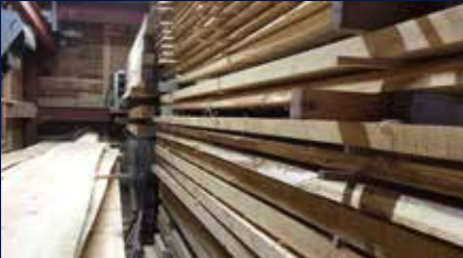
【導入した超低温乾燥設備の内部】
