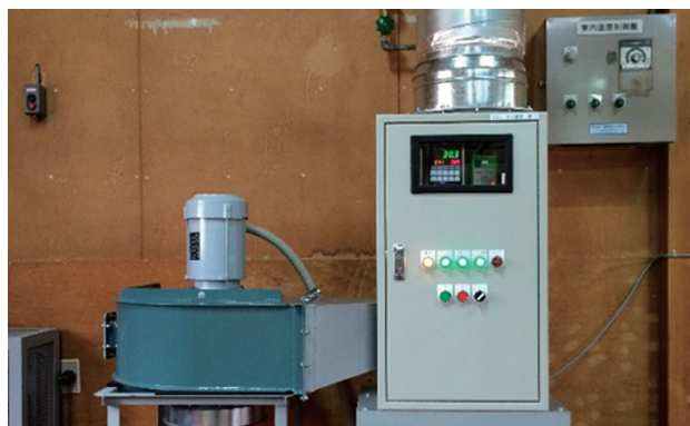
導入設備：LPガス小型温風発生機
