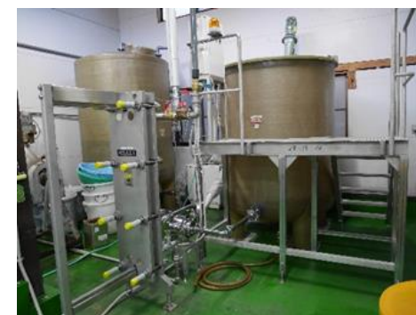
プレート式熱交換器・大型タンク・攪拌機等
