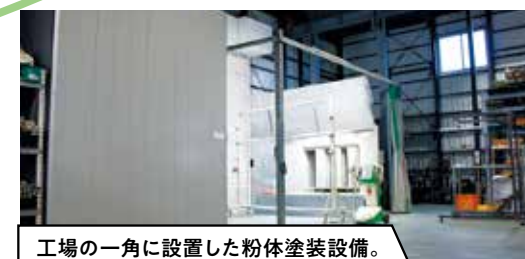
工場の一角に設置した粉体塗装設備。移動することも可能。
