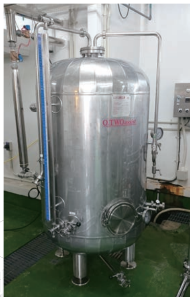
導入したイタリア製スパークリングタンク
