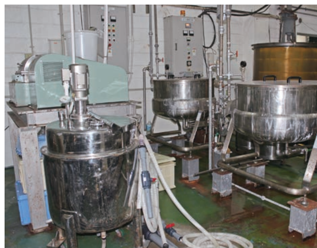
導入した製塩用機械設備
