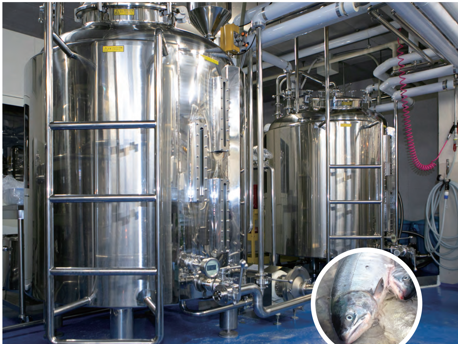
「アンセリン」の酵素処理プラントシステム
