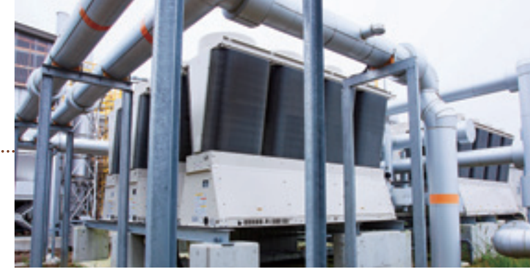
今回導入した空冷ヒートポンプチラー。
