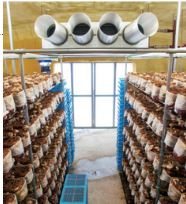
空冷ヒートポンプチラーから作られる冷水から供給される冷氣により、栽培ハウス内の温度を調節している。
