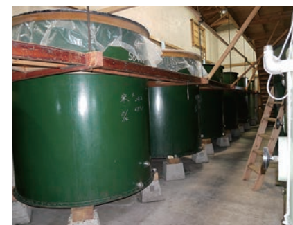
仕込み蔵内の貯蔵タンク
