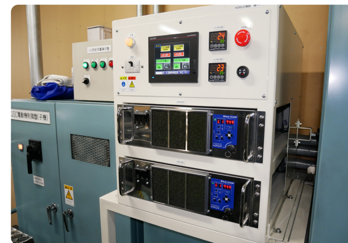
UV-LED装置の光源制御部
