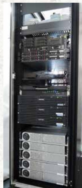
本部に設置された基幹システム（サーバー）
