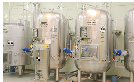
◀ 導入した温度コントロール装置付き高耐圧タンク2基
