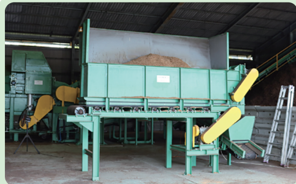
木材ダストを粉砕機に定量供給する木材ダスト槽
