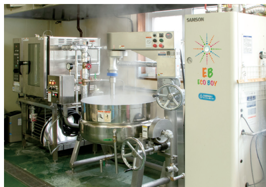
回転式蒸発窯、蒸気ボイラー、スチームコンベクション
