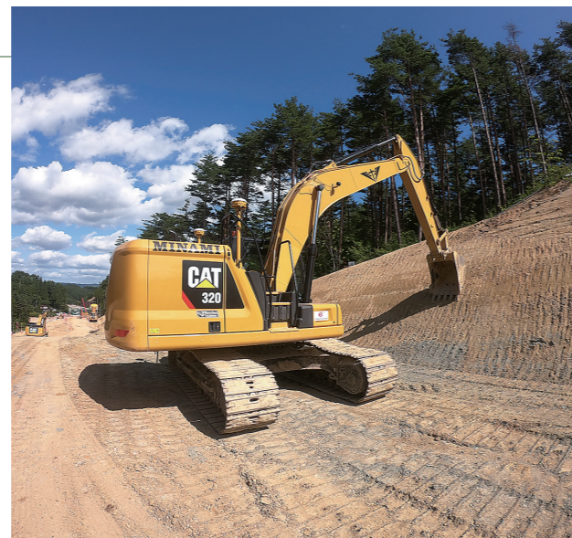
本事業で導入した、キャタピラージャパン製、情報化施工の油圧ショベル。ICT機器と組み合わせ使用している。
