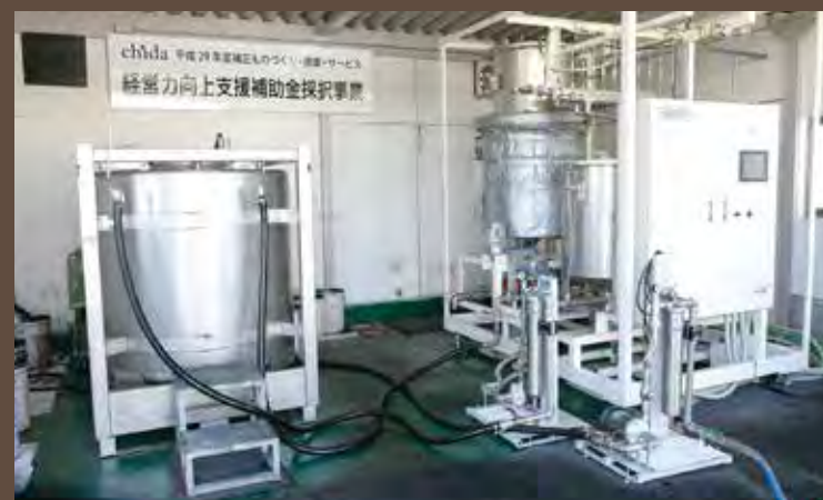
BDF蒸留装置は1日400リットルの製造が可能だ
