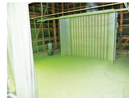
塗料ミストが床下に散乱した乾式塗装ブース
