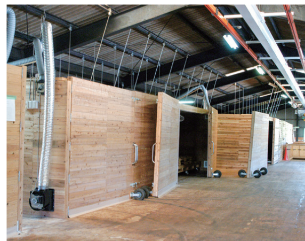
工場の2階に遠赤低温乾燥機を設置し、製造量の増加に対応
