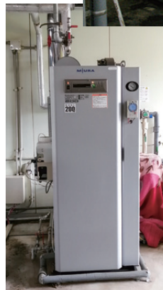
新規導入した ボイラー
