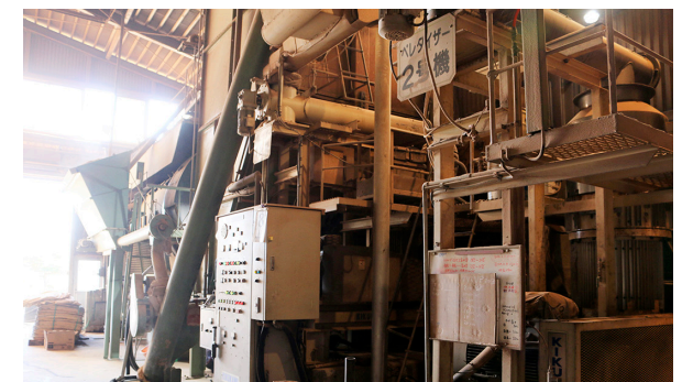
ペレットの製造プラント
