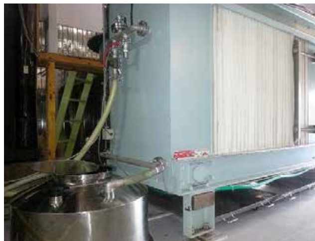
藪田式自動圧搾ろ過機（H26年度導入設備）
