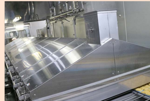
導入した連続式蒸気製造ライン
