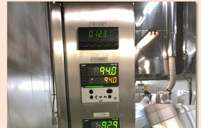
自動で蒸気の入排出が調節されるため蒸室内温度はほぼ均一を保っている
